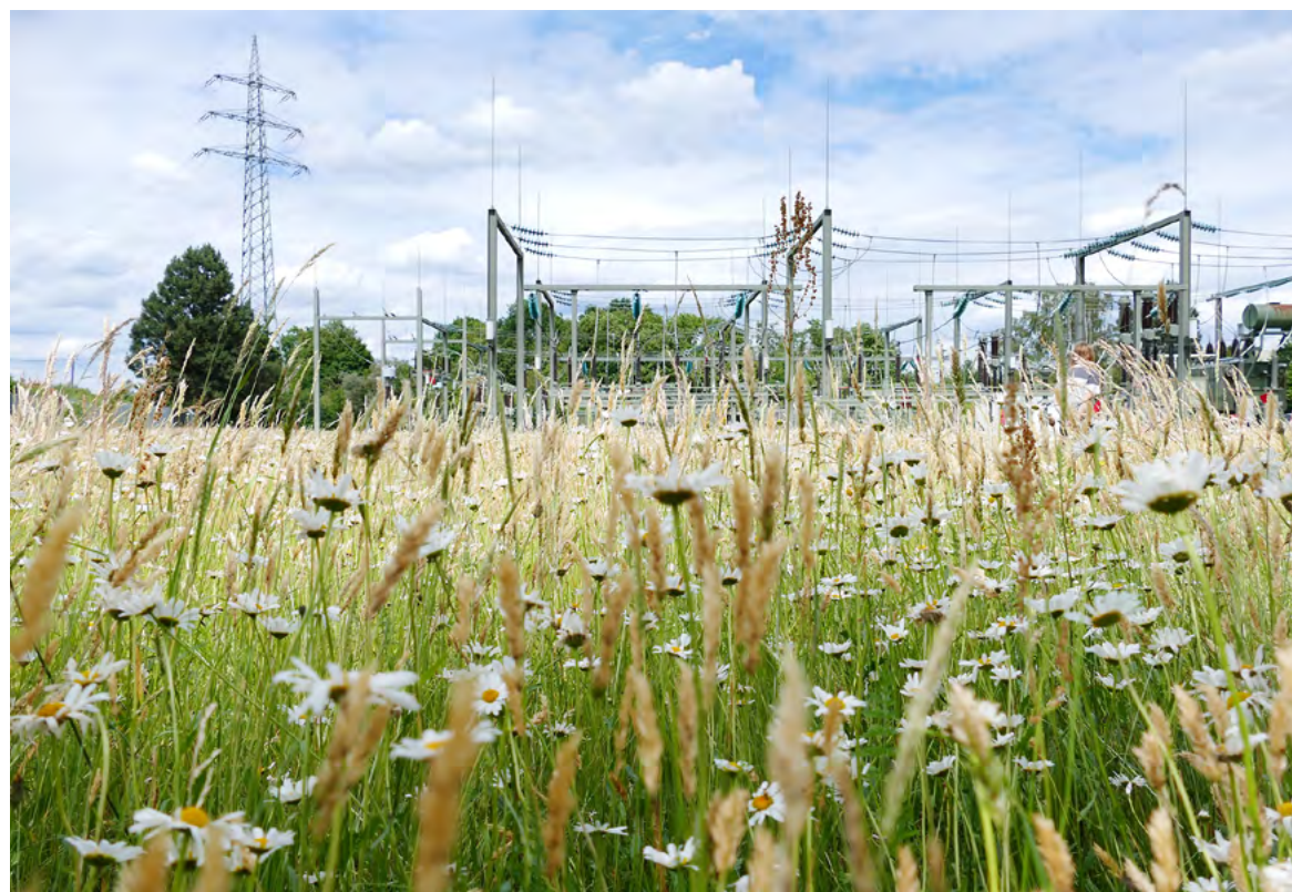
Unsere Umspannanlagen werden nach und nach ökologisch aufgewertet
