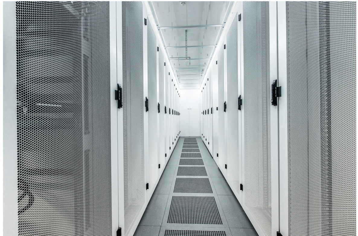
Das Rechenzentrum DARZ – eines der umweltfreundlichsten Rechenzentren Europas
