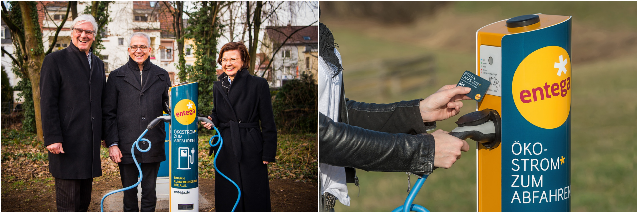
Zum Abschluss des Projekts weihen im Februar 2018 der hessische Wirtschaftsminister Tarek Al-Wazir gemeinsam mit Dr. Marie-Luise Wolff, Vorstandsvorsitzende der ENTEGA AG, und Jochen Partsch (li.), Oberbürgermeister der Wissenschaftsstadt Darmstadt, die letzte Ladesäule ein.
